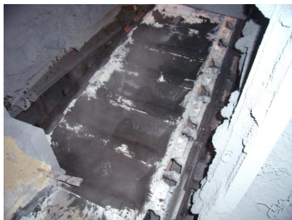
Рисунок 2 – Обработка изложниц разливочной машины антипригарным покрытием на основе микрокремнезема (пыли сухой газоочистки).
